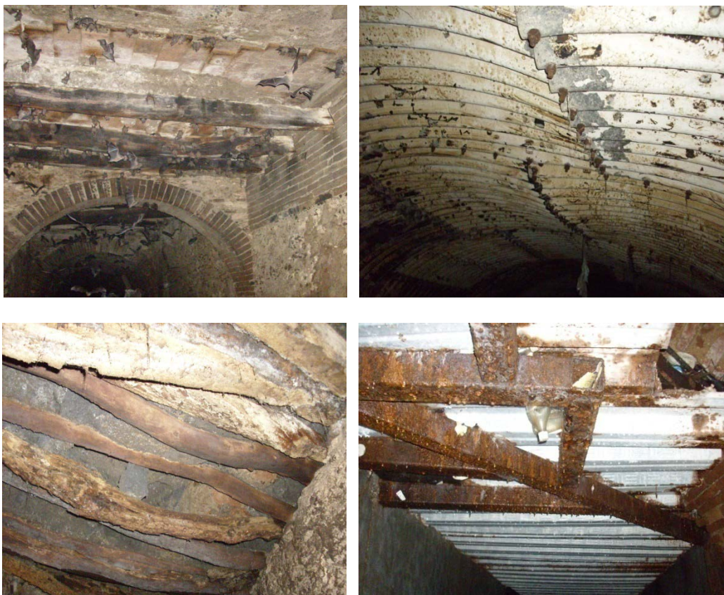
Figura 39. Fotografías superior derecho e izquierdo, deterioro en estructura del embovedado de 4ª Norte y 4ª Oriente. Fotografía inferior izquierda, corrosión en estructura del embovedado del barrio San Roque. Fotografía inferior derecha, deterioro y corrosión de la estructura del embovedado de 5ª Poniente a la altura del Barrio
