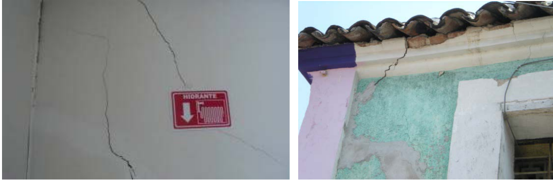
Figura 32. Fotografías de los daños causados por el sismo de Las Choapas de 2011 en edificios públicos de Tuxtla Gutiérrez (González et al., 2011b). Fotografía superior izquierda, edificio Corzo. Fotografía superior derecha, hundimiento en rectoría de la UNICACH. Fotografía intermedia izquierda, instalaciones de COCYTECH. Fotografía intermedia derecha e inferior izquierda, hospital de especialidades “Vida mejor”. Fotografía inferior derecha vivienda en el centro de la ciudad.
