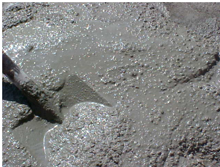
Figura 125. Fotografía que muestra la elaboración de mortero cemento arena con exceso de agua, lo que le provocará fisuraciones y pérdida de resistencia
